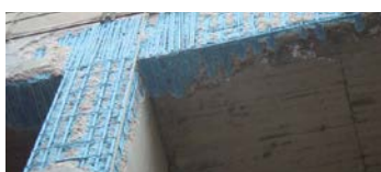
Edificio "Añadidos al Cemento" en Lafarge Cementos, Sagunto (Valencia) Productos utilizados: Mapefer 1K.
