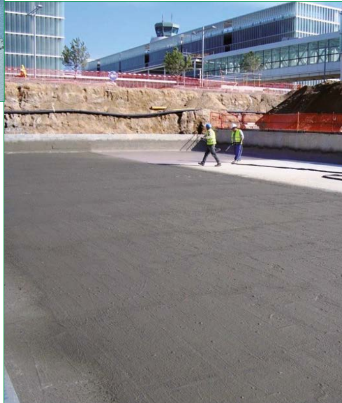
UTE Tuneladora Metro Línea 9 en el Prat de Llobregat (Barcelona). Productos utilizados: Mapelastic , Malla de fibra de vidrio y Mapelastic Smart .
