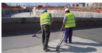
UTE Tuneladora Metro Línea 9 en el Prat de Llobregat (Barcelona). Productos utilizados: Mapelastic, Malla de fibra de vidrio y Mapelastic Smart.
